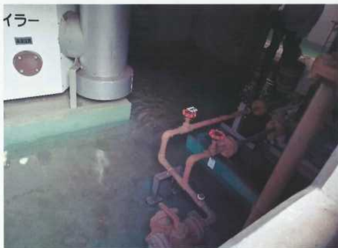
写真② 灯油ポンプ室
