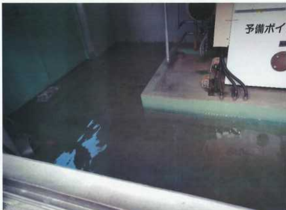
写真① 灯油ポンプ室
